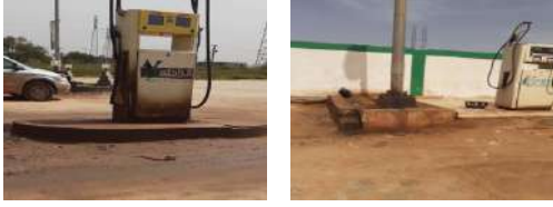
صورة (1) تسرب الوقود من المضخات اثناء الاستخدام من قبل المواطن
